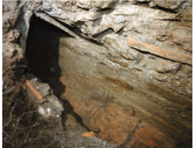
Figura 8. Spalletta occidentale della fognatura. Si nota l'interruzione della copertura a cappuccina.
